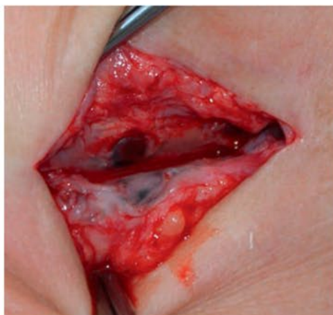
Abbildung 2: Korrosion im Plattenlager.
